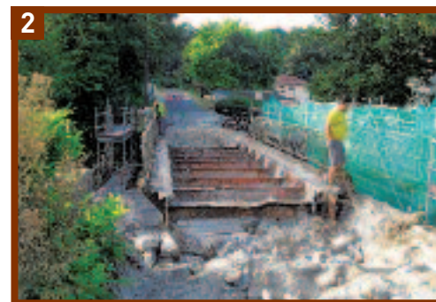
Destruction de la voirie et des tabliers
